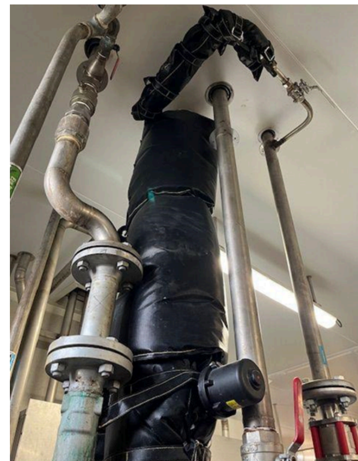
isolation des conduites vapeur et des vannes grâce à des matelas isolants
